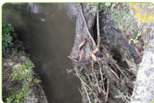
Embâcle au niveau d'une pile de pont à Rennemoulin (sept. 2016)
